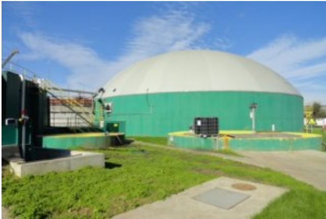
CHP biogasno posstrojenje "MIROTIN-ENERGO" Vrbas
